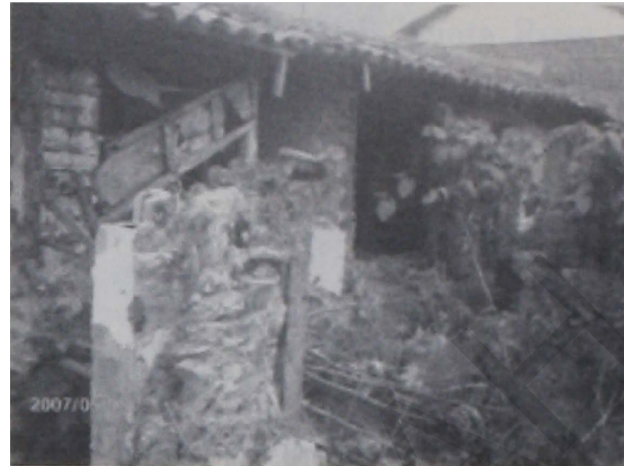
Paredes de bahareque destruidas.
