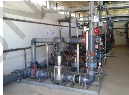
Ilustración 7 Planta Potabilizadora de Agua, Ciudad Olanchito
