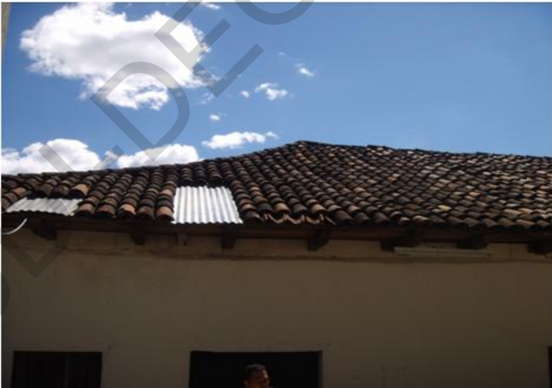
Fotografía No. "4" mostrando el avanzado deterioro de los techos d la escuela
