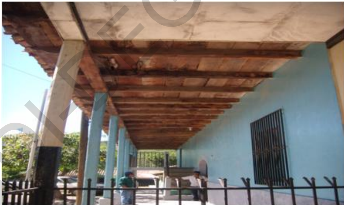
Fotografía No. "6" muestra el avanzado deterioro de las vigas de los techos
