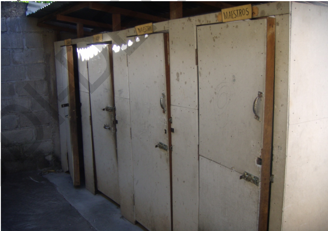
Fotografía No. "8" muestra la condición de los sanitarios
