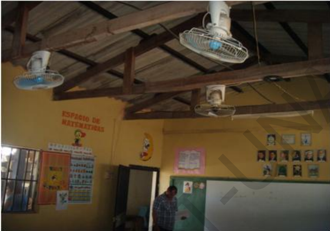
Fotografía No. "3" mostrando el interior de los techos de la escuela
