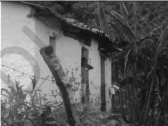
CASA CON CANAL RECOLECTOR DE AGUA
