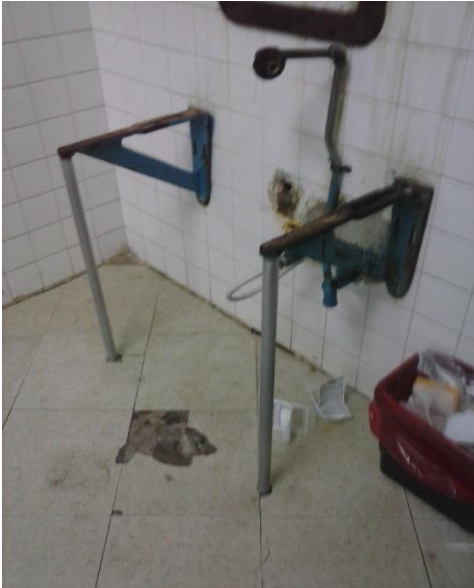
Lavamanos en mal estado.
