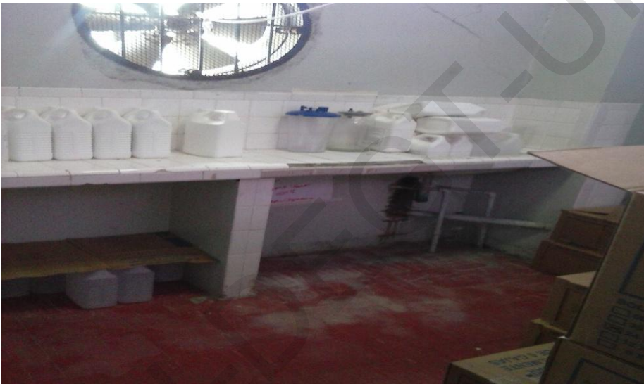
Lavabo para material sucio en mal estado sirve para almacenar soluciones
