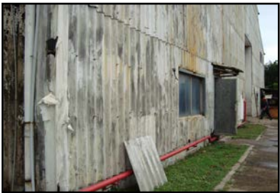
Fotografía No. 4. Deterioro de las placas constructivas de amianto.
