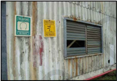
Fotografía No. 5. Falta de señales advirtiendo el material de las placas constructivas.
