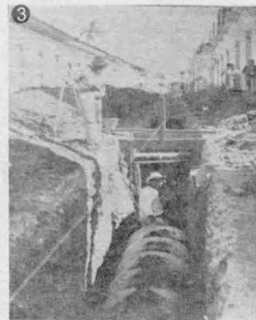
3 La tubería del alcantarillado enterrada en una de las calles céntricas de la ciudad.
